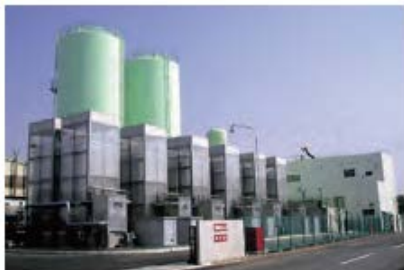
LNG satellite terminal
